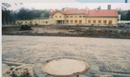
Najwięcej środków z EFRR w ramach ZPORR w przeliczeniu na jednego mieszkańca gminy trafi do Gminy Krośnice. Na zdjęciu: Uzbrojenie terenu dla potrzeb budowy Centrum Edukacyjno-Turystyczno-Sportowego w Krośnicach
