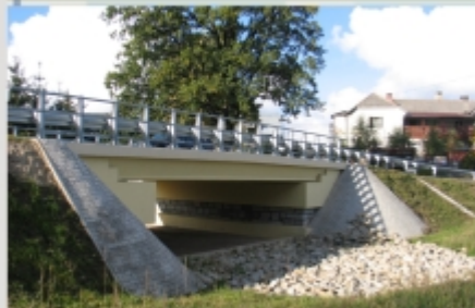
Najwięcej projektów w ramach ZPORR realizuje Samorząd Województwa Dolnośląskiego. Na zdjęciu: Przebudowa mostu w miejscowości Kostrzyca (powiat jeleniogórski)
