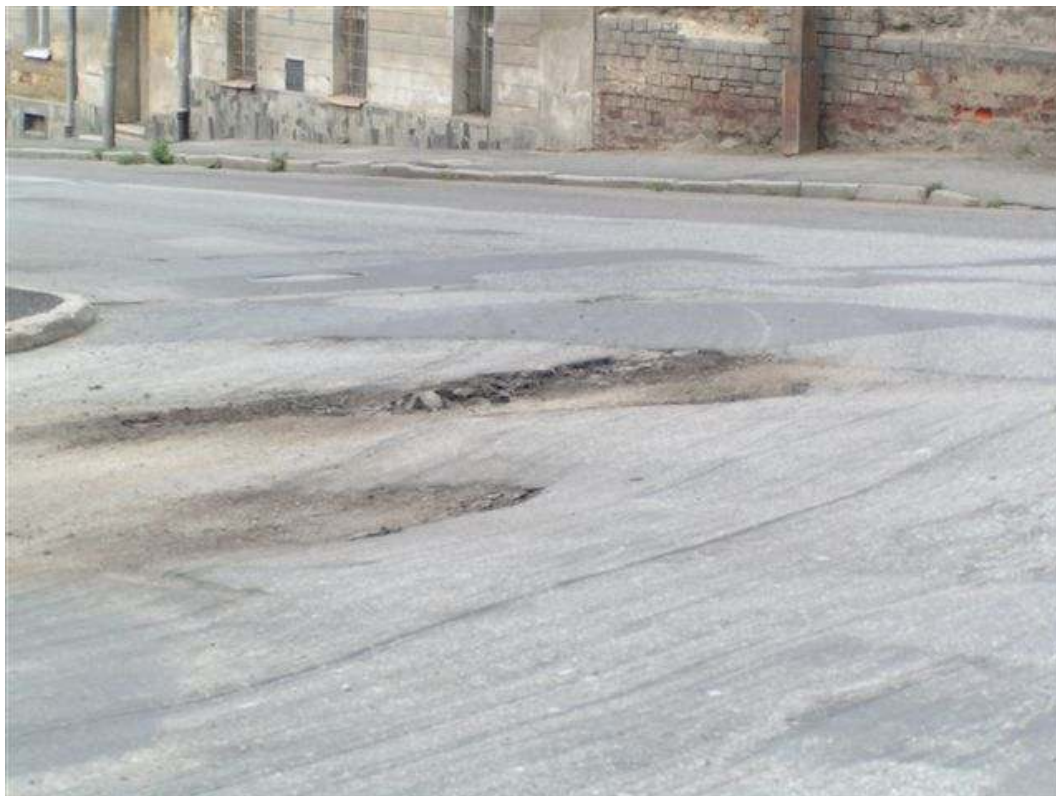
Fot. 2.2.1. Odcinek drogi dojazdowej do drogi krajowej nr 382 w Ząbkowicach Śl. zniszczony w wyniku intensyfikacji transportu surowców skalnych z okolicznych kopalń (fot. UM Ząbkowice Śl., 2008, @ http://www.zabkowiceslaskie.pl/akt )
