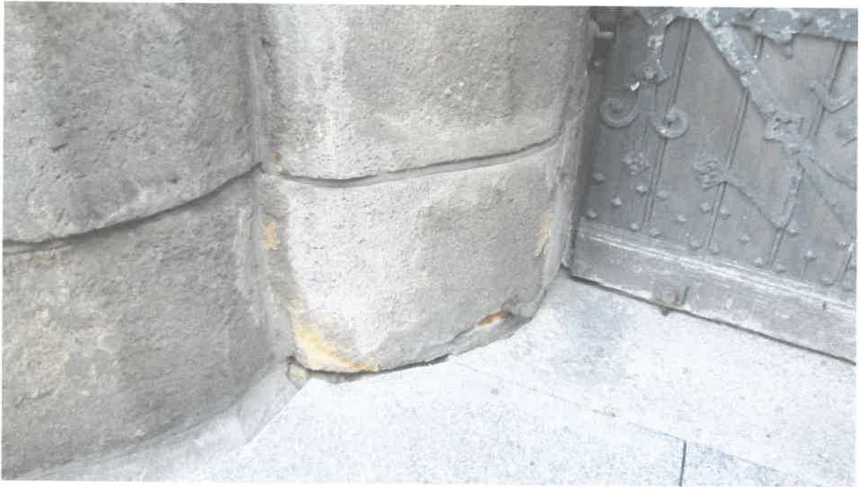
Fot. 3 Legnica, Gotycki portal, elewacja zachodnia Katedry Świętych Apostołów Piotra i Pawła w Legnicy, XV w. Widok detalu. Widoczny stan zachowania elementów kamiennych. Fot. Mateusz Stankiewicz 2022
