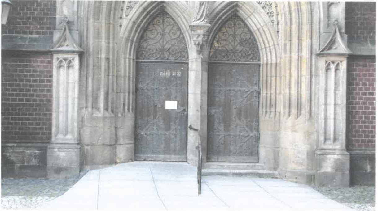
Il. 3 Katedra św. św. Piotra i Pawła w Legnicy. Widok na zachodnią elewację Katedry. Detal, widoczny stan zachowania elementów kamiennych oraz drzwi. Legnica, 2022, Fot. Mateusz Stankiewicz
