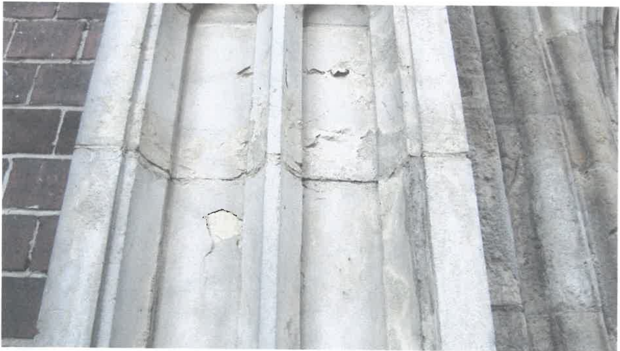
Fot. 4 Legnica, Gotycki portal, elewacja zachodnia. Katedry Świętych Apostołów Piotra i Pawła w Legnicy, XV w. Widok detalu. Widoczny stan zachowania elementów kamiennych. Rozwarstwienie spowodowane hydrofobizacją. Fot. Mateusz Stankiewicz 2022.
