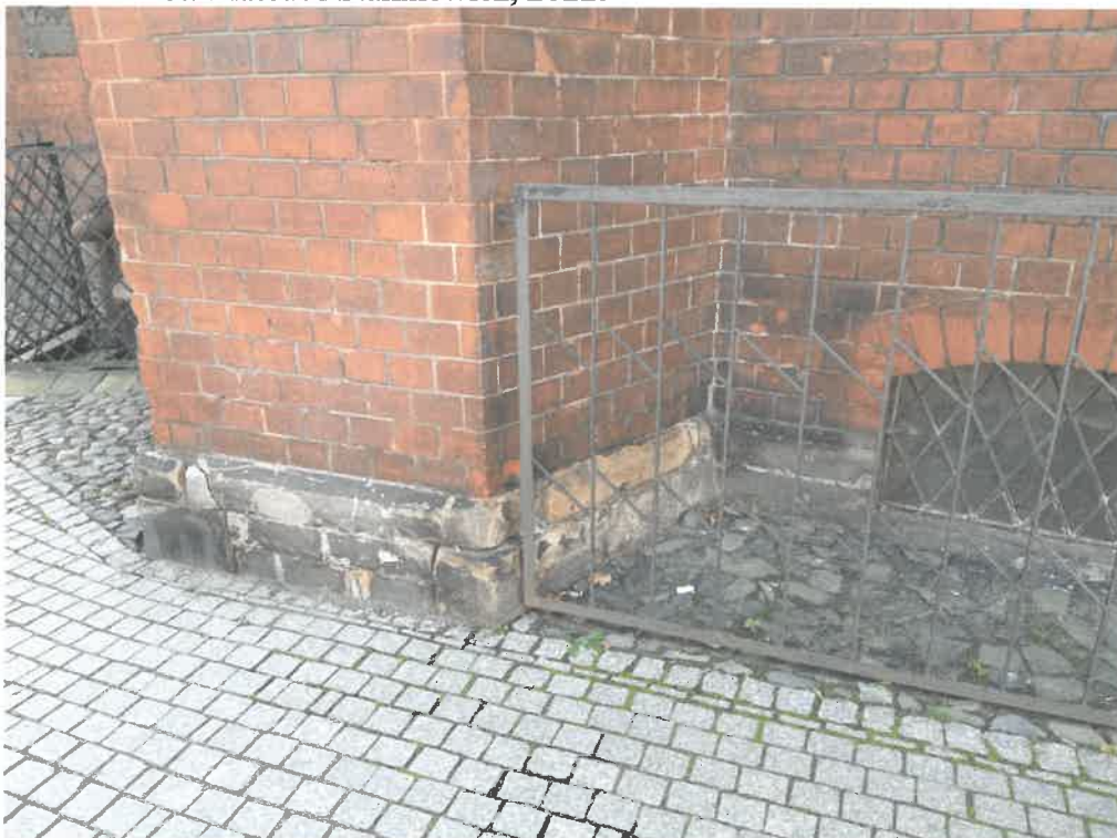
Fot. 9Legnica, , elewacja północna Katedry Świętych Apostołów Piotra i Pawła w Legnicy, XV w. Widok ogólny. Kanał odpływowy przykryty kratką który należy po zabiegu wyczyścić i sprawdzić drożność Fot. Mateusz Stankiewicz, 2022.
