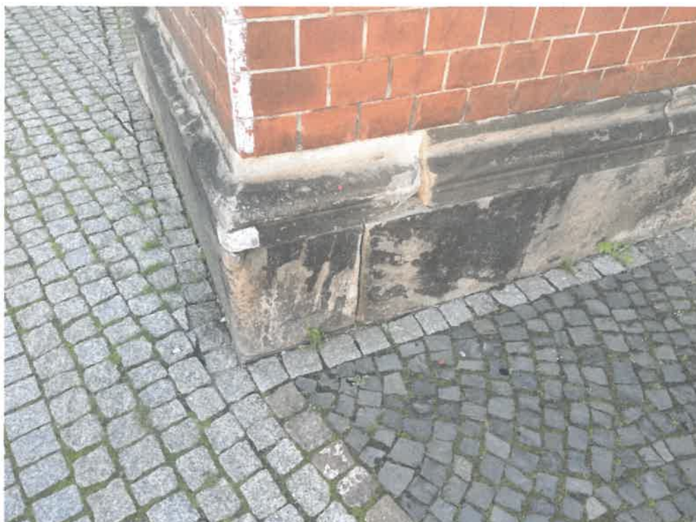
Fot. 5 Legnica, , elewacja południowa, przypora uszkodzenia okapnika cokołu, fałszywa patyna Katedry Świętych Apostołów Piotra i Pawła w Legnicy, XV w. Fot. Mateusz Stankiewicz, 2022.
