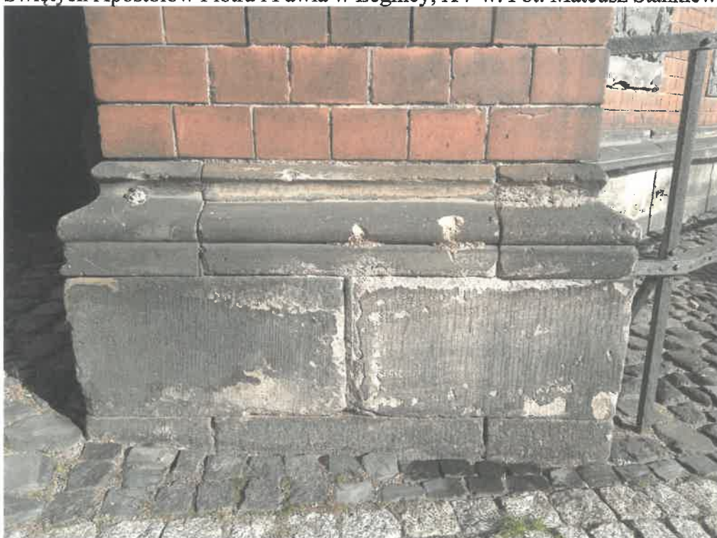
Fot. 6 Legnica, , przypora elewacji południowej Katedry Świętych Apostołów Piotra i Pawła w Legnicy, XV w. Czarna patyna ubytki w formie i zachowany sposób fakturowania szarnir. Fot. Mateusz Stankiewicz, 2022.
